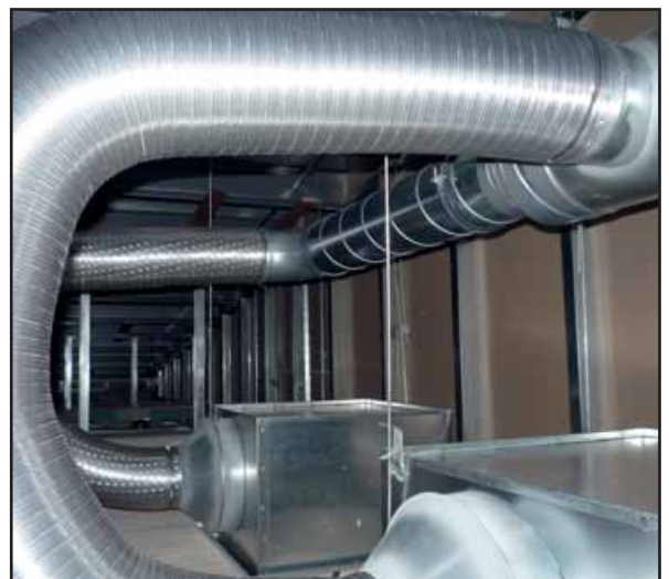
kundenspezifisch konfektionierte Abluftanlage
